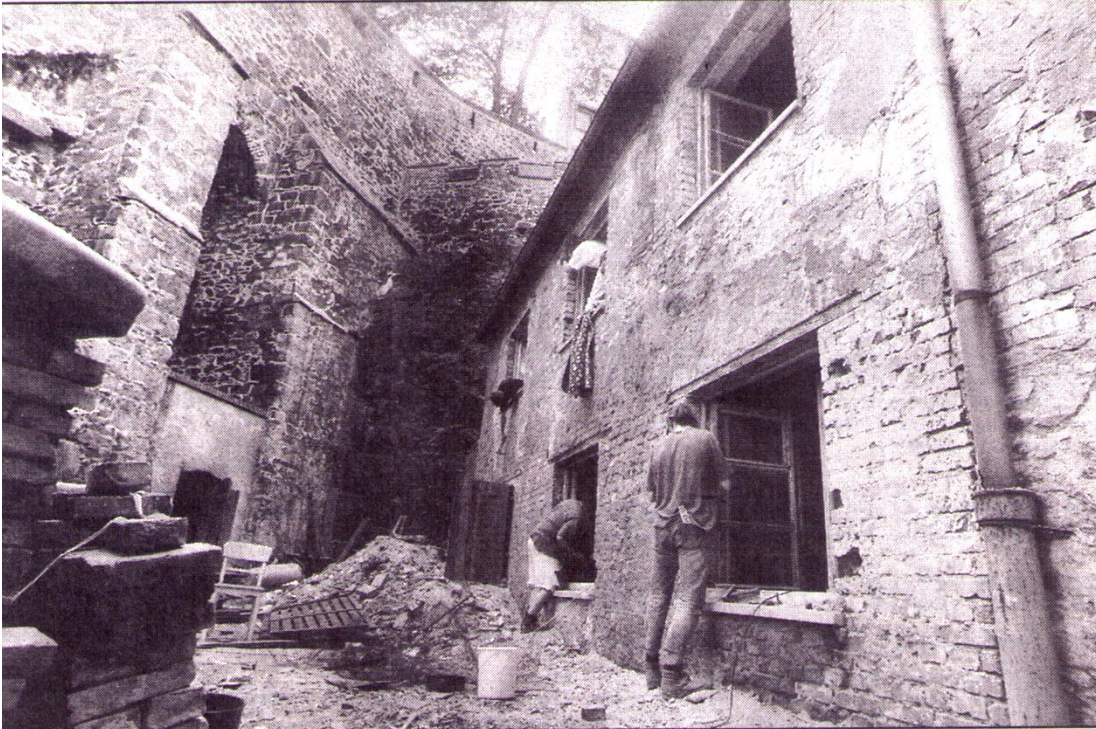
Fast jeden Nachmittag sind Jugendliche hier in dem desolaten Gebäude Hotherstraße 25 zum Entrümpeln.
